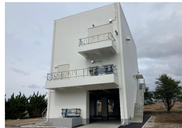
【豊岩取水場 非常用自家発電設備棟】 停電時に使用する設備を設置する施設です。地上3階建の建物の構築が完了し、今後電気設備工事を行います。
