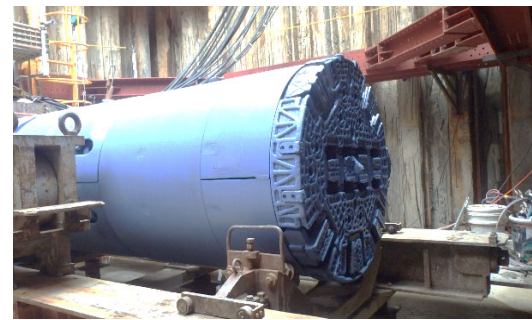
【仁井田浄水場 場内配管工事】 手形山配水場などへの送水のための配管を地下に敷設しています。地中を専用の機械で掘削中です。
